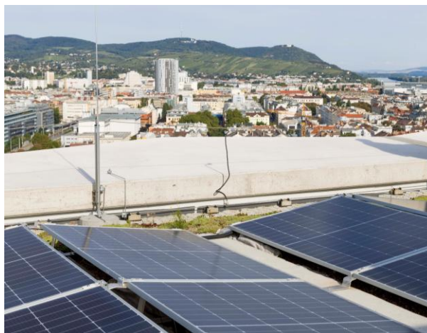
4 Photovoltaikanlage auf dem Haus Leywand
